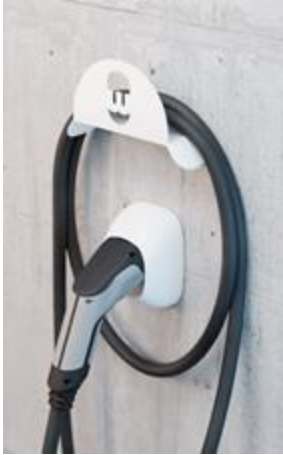
Laadkabels en kabelhouder
